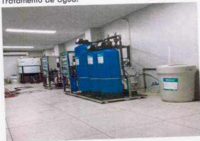
Tratamento de água:
