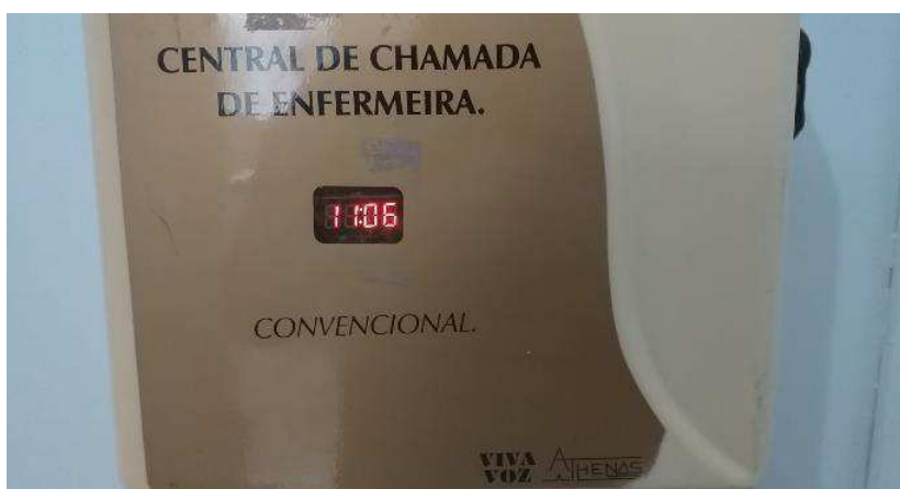
Figura 1. Central de chamada instalada funcionando
