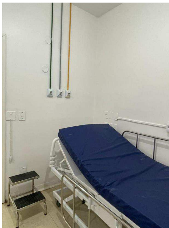
Figura 7. Interruptor instalado na enfermaria 11
