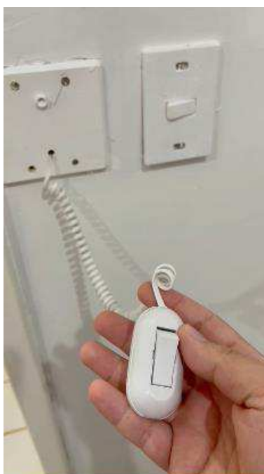
Figura 2. Interruptor instalado ao lado dos leitos
