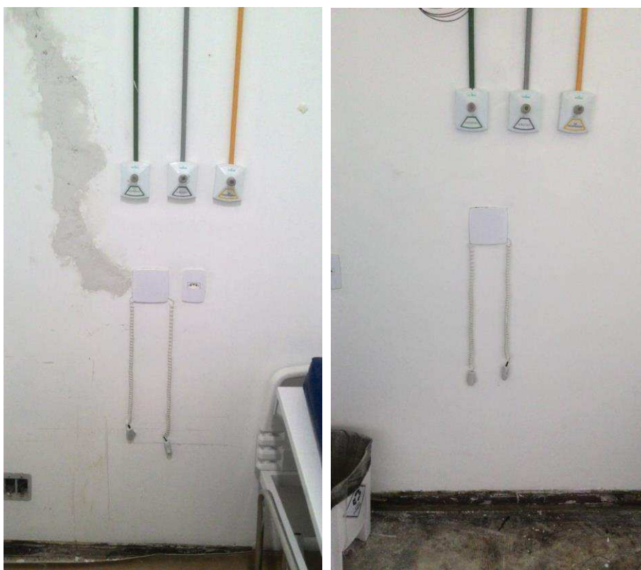
Figura 6. Interruptores instalados nas enfermarias 16 e 17.
