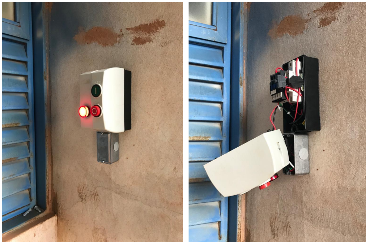
INSTALAÇÃO DE QUADRO DE AUTOMAÇÃO PARA AUTOABASTECIMENTO DA CAIXA D'ÁGUA CENTRAL.
