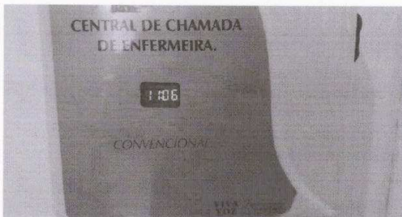
Figura 1. Central de chamada instalada funcionando
