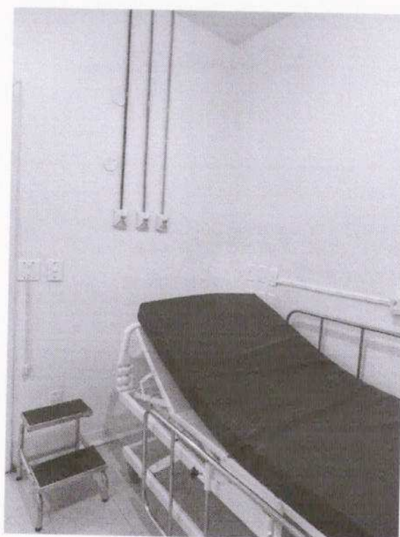
Figura 7. Interruptor instalado na enfermaria 11
