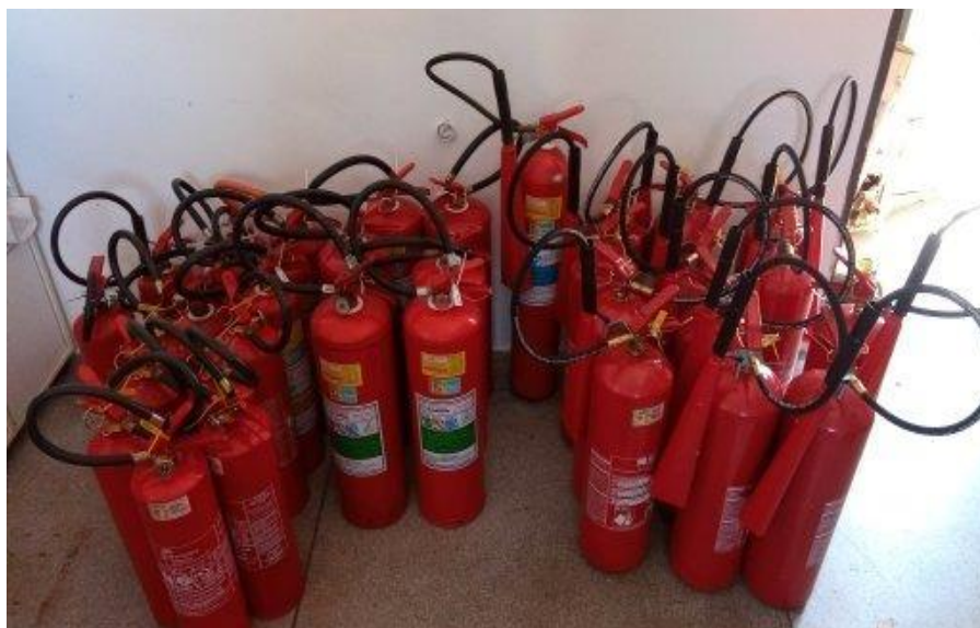
Foto 8: Novos Extintores de incêndio adquiridos
